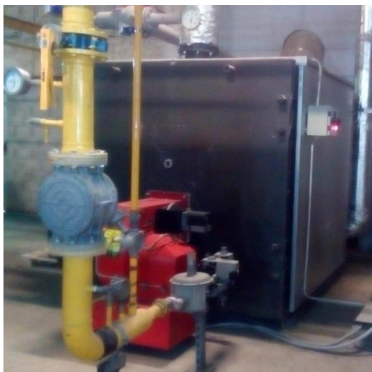
Εικόνα 10: Λέβητας αερίου στο Mediterranean Cosmos
