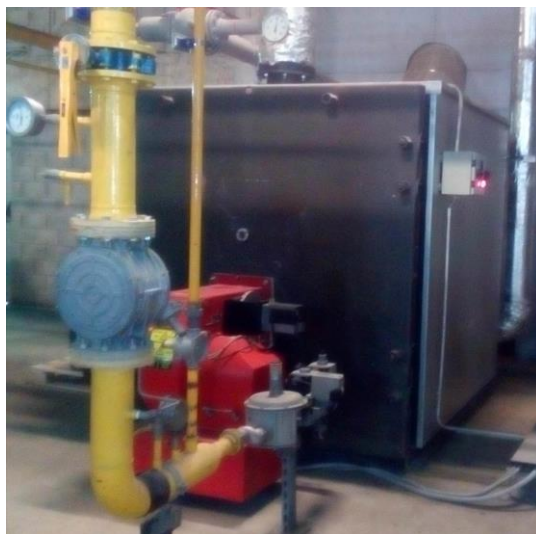
Εικόνα 10: Λέβητας αερίου στο Mediterranean Cosmos
